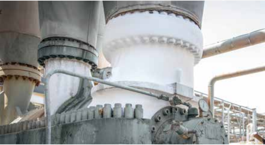
يتجمع الجليد على الأنابيب التي يتم فيها فصل الغاز الطبيعي المسال عن غاز الميثان الخفيف. ولا تتم عملية الفصل إلا عند وصول درجة حرارة الغاز إلى 71 درجة تحت الصفر المئوي.
